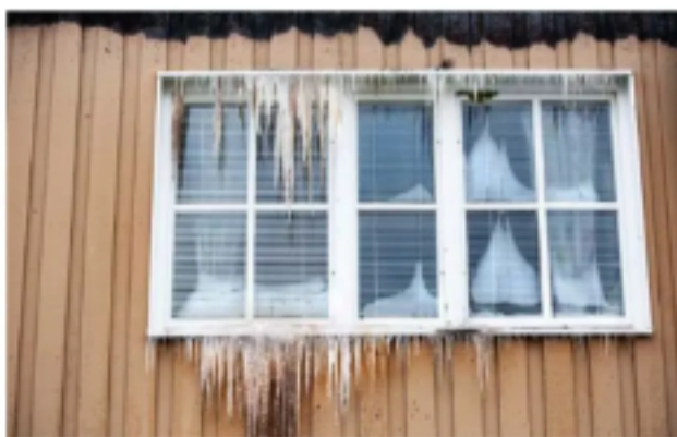
Istappar och immiga fönster är några av de spår som syns efter branden. FOTO: LARS DAFGÅRD
