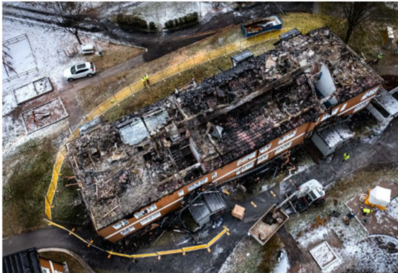
Flerfamiljshuset på Jungfruvägen i Falun. Hela övervåningen är borta och resten av byggnaden är rök och vattenskadad. "Här kan ingen bo längre" sa räddningsledare Mikaela Warberg till Falu-Kuriren på morgonen efter branden. FOTO: LARS DAFGÅRD
